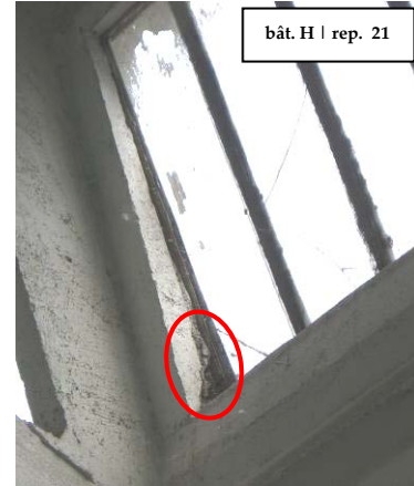
béton dégradé en base de meneau
