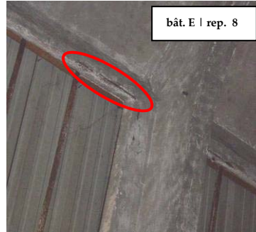
éclat d'arrêtes de linteau (acier corrodé apparent)
