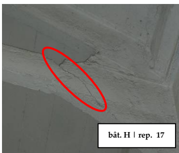
fissuration importante en pied d'entrail avec section réduite
