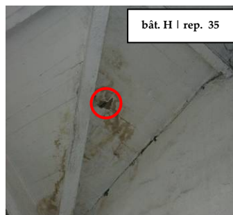
éclatement du béton dû à l'oxydation des armatures (aciers apparents)
