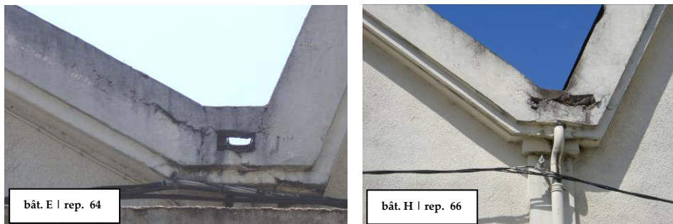
sorties de chéneaux en très mauvais état, fissure conséquente et aciers apparents
