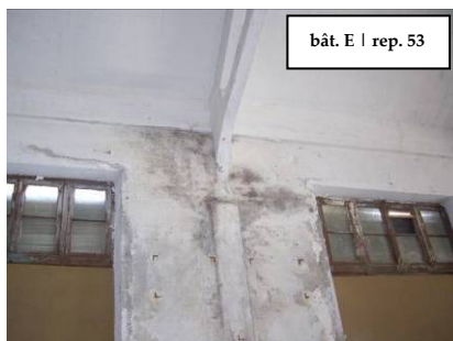
infiltration d'eau en tête de poteau
