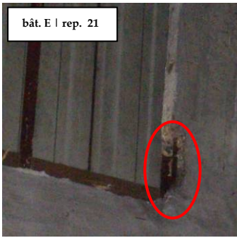
éclat du béton en base de meneau (acier corrodé apparent)
