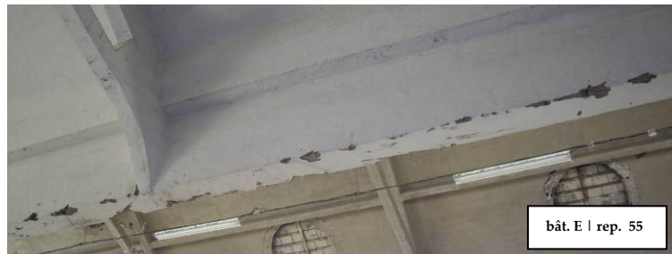
nombreuses épaufrures conséquentes le long de la poutre de rive avec acier souvent apparents
